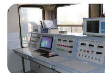
变压器实验控制台
